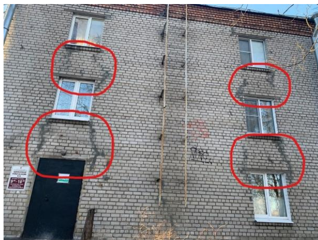
Рис. 1. Трещины в кирпичной стене
