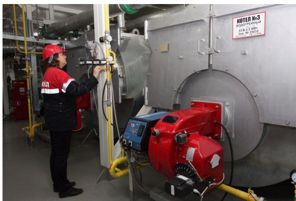
Рис. 1. СКЗ газовой котельной: шумопоглощающий кожух на газовое оборудование
