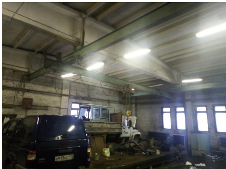
Рис. 1. Общий вид цеха с кран-балкой
